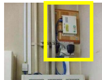
緊急地震速報受信機設置状況
