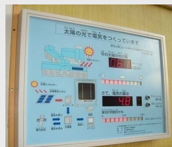
発電量モニター
