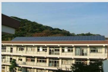
太陽光パネル
