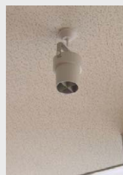
天井に取付けた装置
