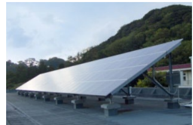
太陽光パネル
