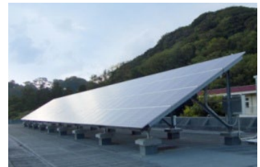
太陽光パネル
